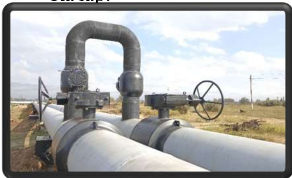
Протяженность магистральных тепловых сетей – 36,6 км.
